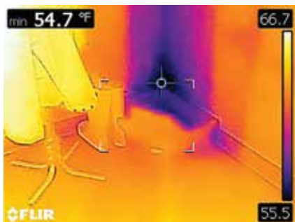
方框区域中的冷点表明漏风
