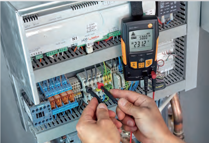
测量热泵开关盒中的电压
