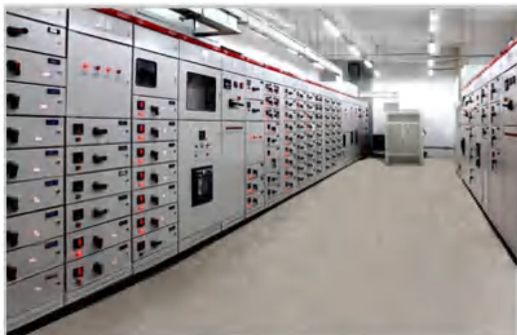
中低压配电柜
