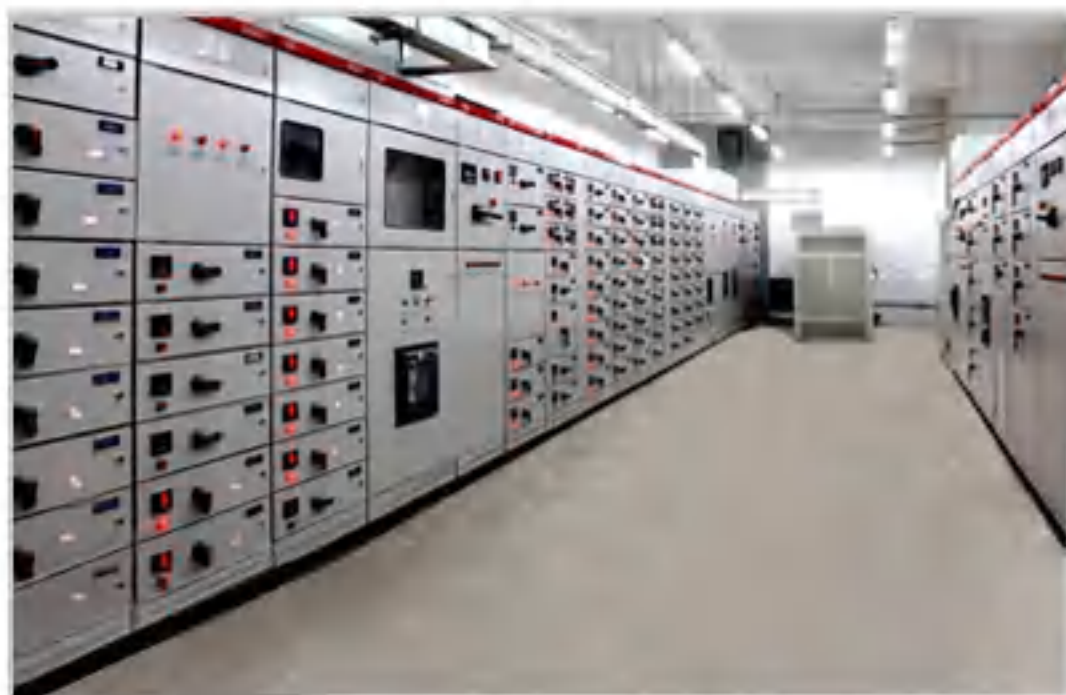
中低压配电柜
