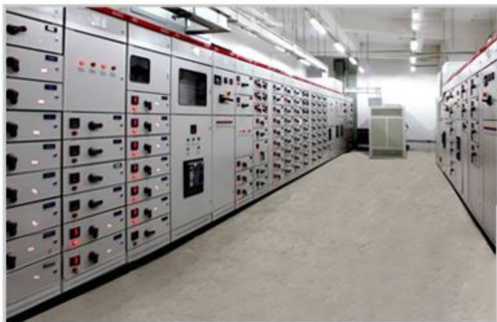
中低压配电柜
