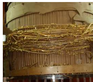
分接绕组塌陷
